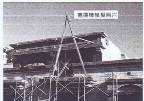
案6. 墜落—從事吊料口堆置作業墜落致死
