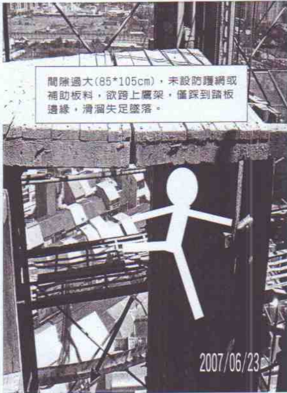
案5. 墜落滾落—泥作吊運物料墜落致死
